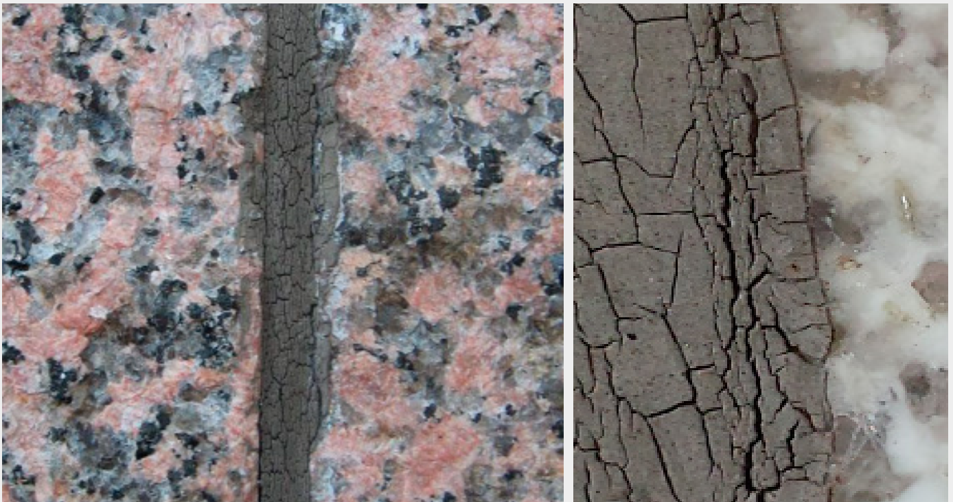
Figura 4. Exemplos de selantes orgânicos com degradação
